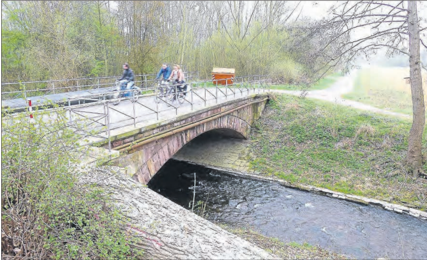
400 Müllaster pro Tag: Über diese alte Losse-Brücke – eigentlich ein Radweg – soll von Juni bis September der Lkw-Verkehr rollen, wenn die Brücke Am Lossewerk saniert wird. Weil die alte Brücke schmal ist, ist Gegenverkehr nicht möglich. So werden die Mülltransporter nach Abladen ihrer Fracht am Müllheizkraftwerk weiter nach Salzmannshausen durch die Rauschenberger Straße geleitet. Foto: Naumann
